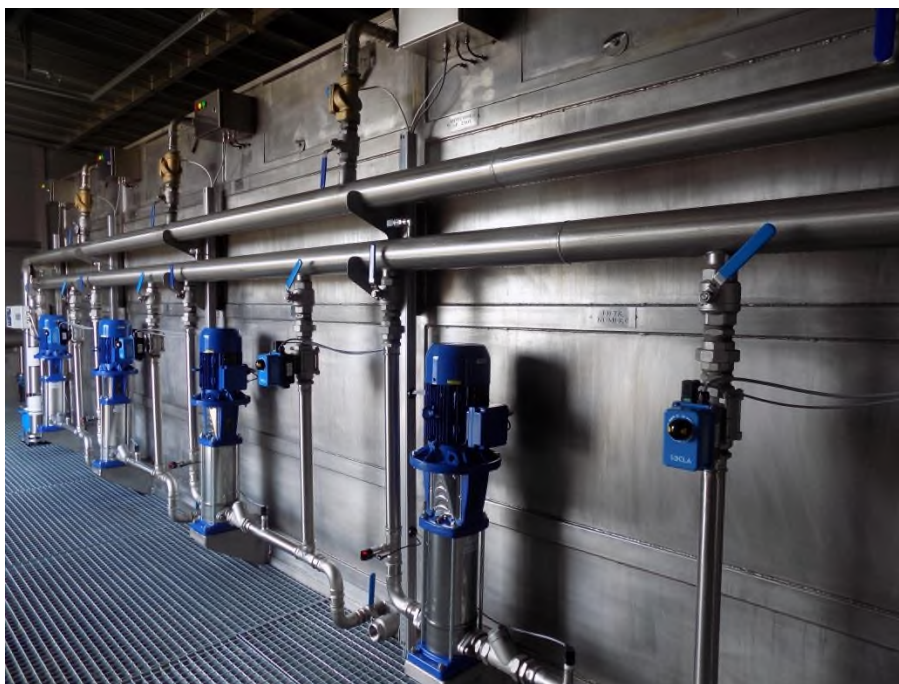
System sterownia pracą filtrów
